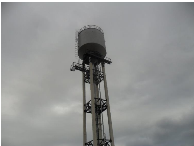
Joonis 5-9 Sanatooriumi puurkaevu juures paiknev 24 m kõrgune veetorn
