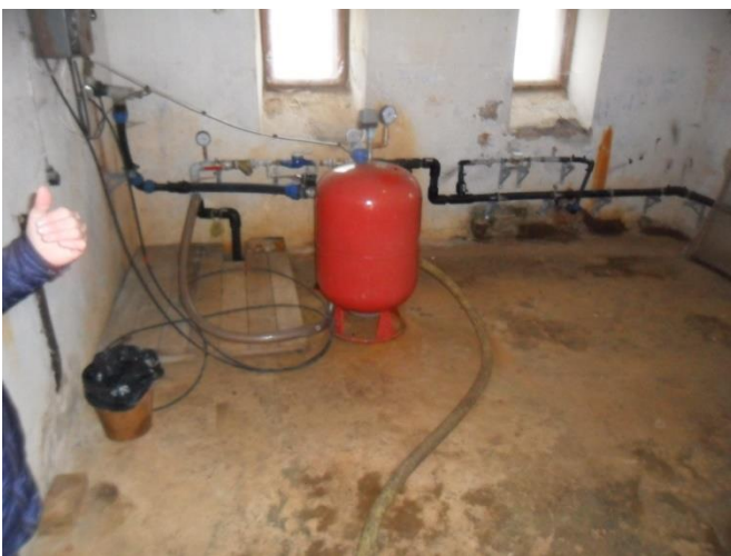
Joonis 5-8 Gümnaasiumi puurkaevpumpla sisevaade
