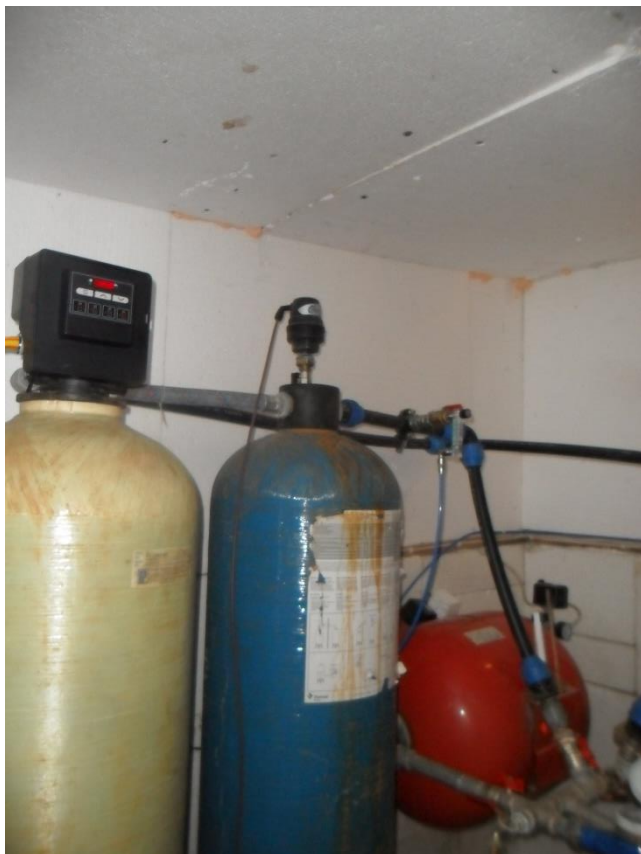
Joonis 5-5 Toila sadama puurkaevpumppla sisevaade (aeratsioonipaak, filterpaak ja hüdrofoor)
