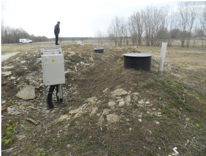
Joonis 6-15 Saka reoveepuhasti välisilme
