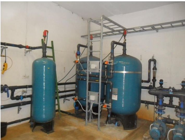
Joonis 5-16 Voka VTJ sisevaade, vasakul aeratsioonipaak, paremal raua- ja mangaanieraldusfiltrid
