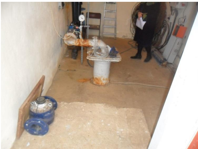
Joonis 5-10 Sanatooriumi puurkaevpumppla hoone sisevaade. Puurkaevu päis paikneb pumplahoones
