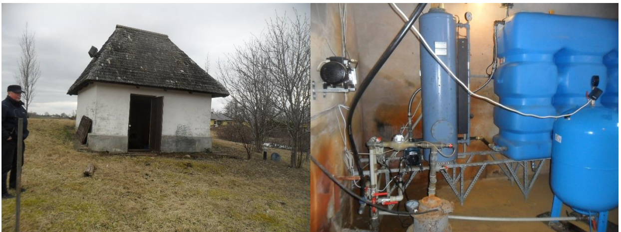
Joonis 5-26 Kabelimetsa pk-pumpla välis- ja sisevaade (teisel fotol puurkaevu päis, filter ja hüdrofoor)
