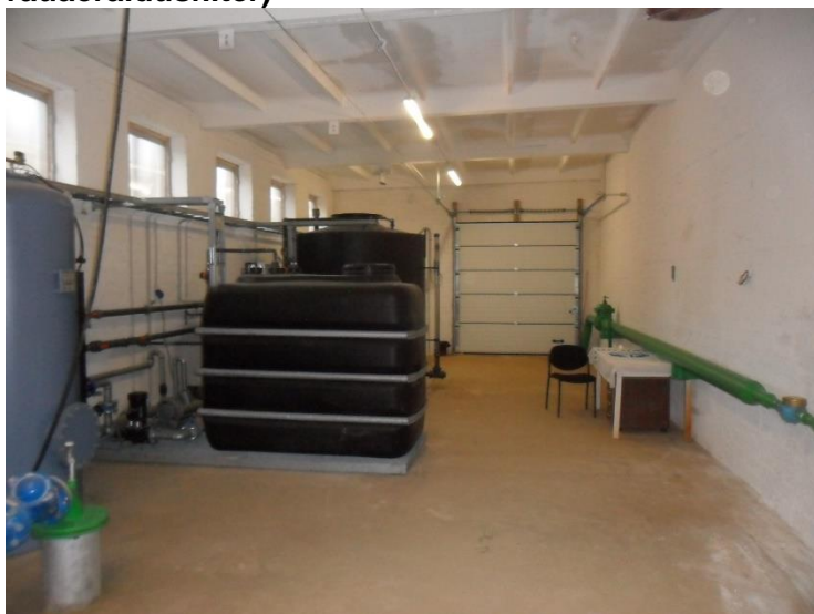
Joonis 5-12 Viru Rand OÜ puurkaevpumppla sisevaade (esimene mahuti pesuveemahuti, tagumine puhtaveereservuaar)
